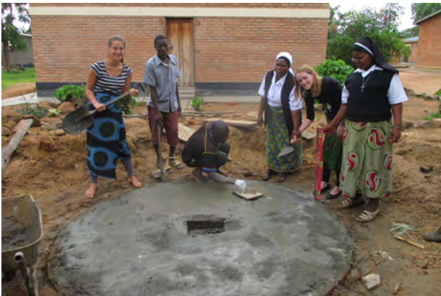
... und ein neuer Wassertank
